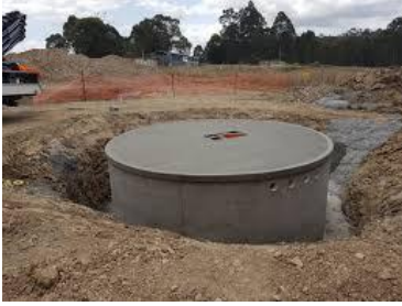
خزانات المياه الجوفية الخرسانية
